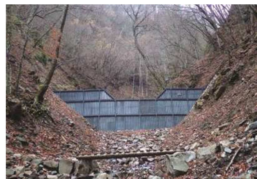
谷止工による溪流の侵食拡大防止
