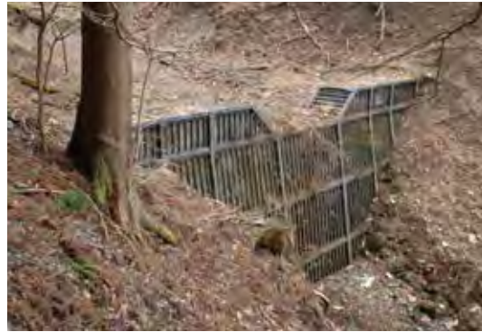
土砂の堆積が進んだえん堤
